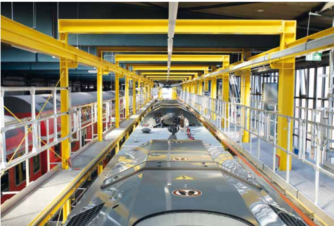
Wenn der Zug in den Dacharbeitsstand eingefahren ist, kann das Wartungsteam mit Spaltmaß Null an und auf den Dächern arbeiten.
