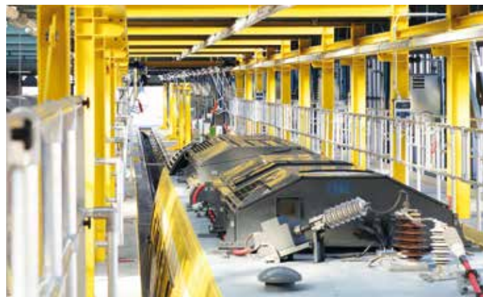
Auf dem Zugdach erledigen die Techniker Wartungsarbeiten, zum Beispiel an Klimaanlage, Stromabnehmern und Fahrmotorlüfter.
