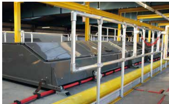
Ein ausgeklügeltes Geländerkonzept garantiert dem Team jederzeit ein absolut sicheres Arbeiten in 3,60 Metern Höhe.
