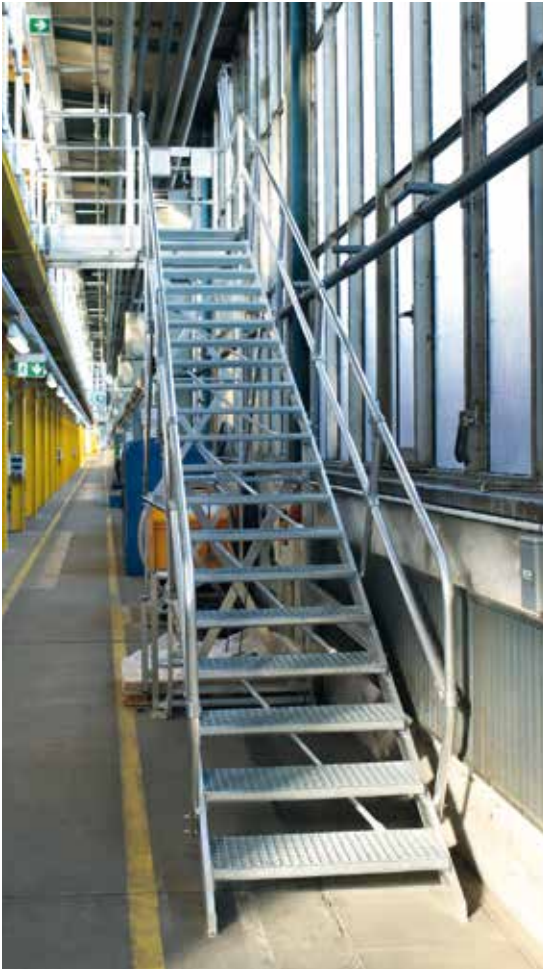
Der Aufstieg auf die Plattformebene erfolgt sicher über Treppen mit Handläufen.
