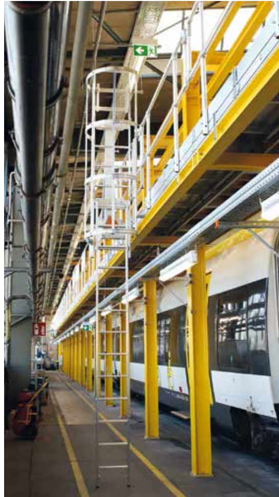
Der 95 Meter lange Dacharbeitsstand ist in der Mitte mit einer Notleiter ausgestattet.
